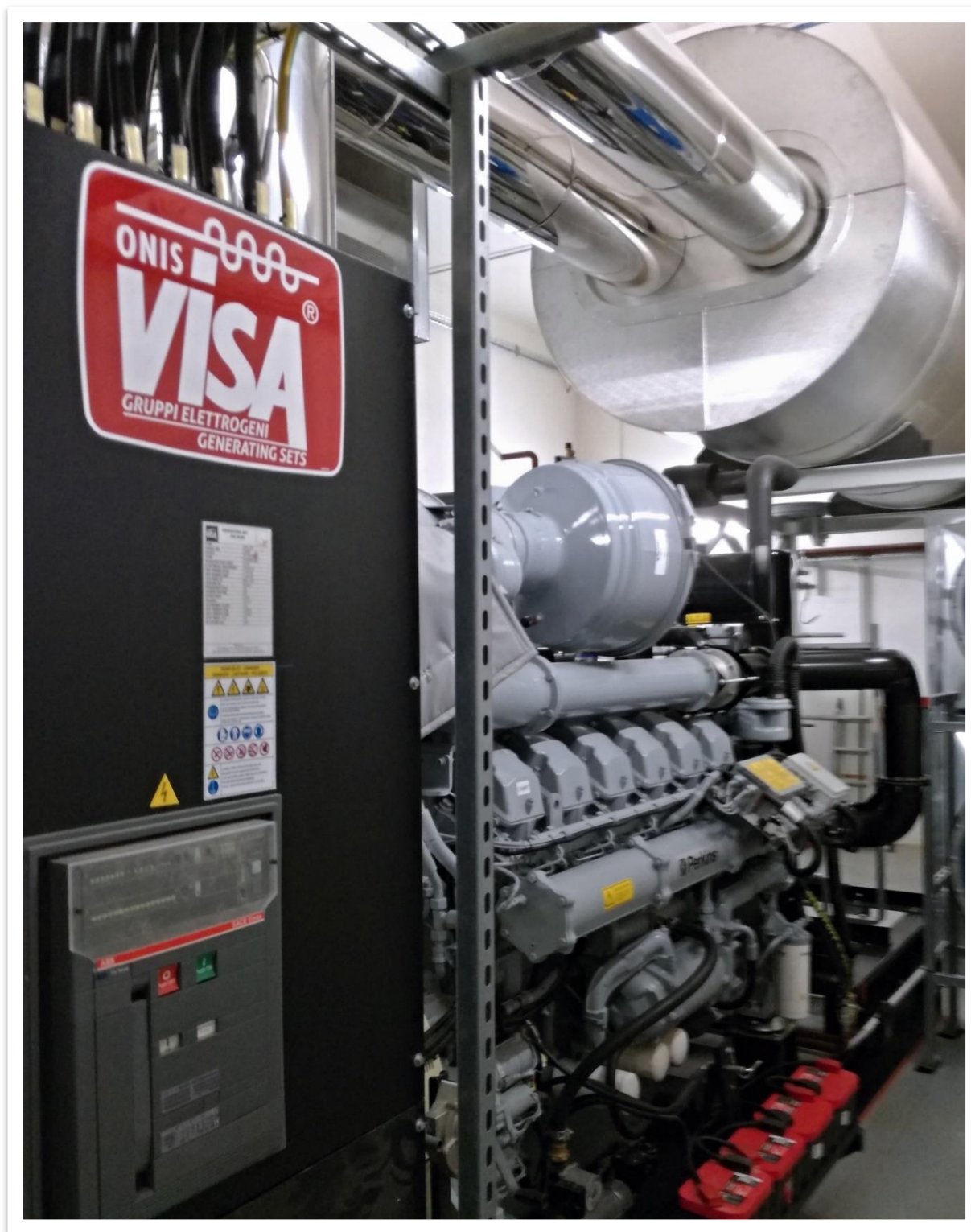
Obr. 6D - Tlumič hluku po zaizolování a dokončení instalace ostatní technologie:
